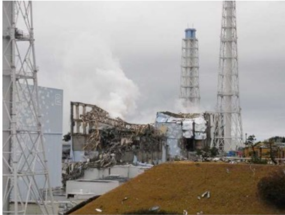
図2 2011年3月15日の4号機原子炉建屋の状況(その1) 7
